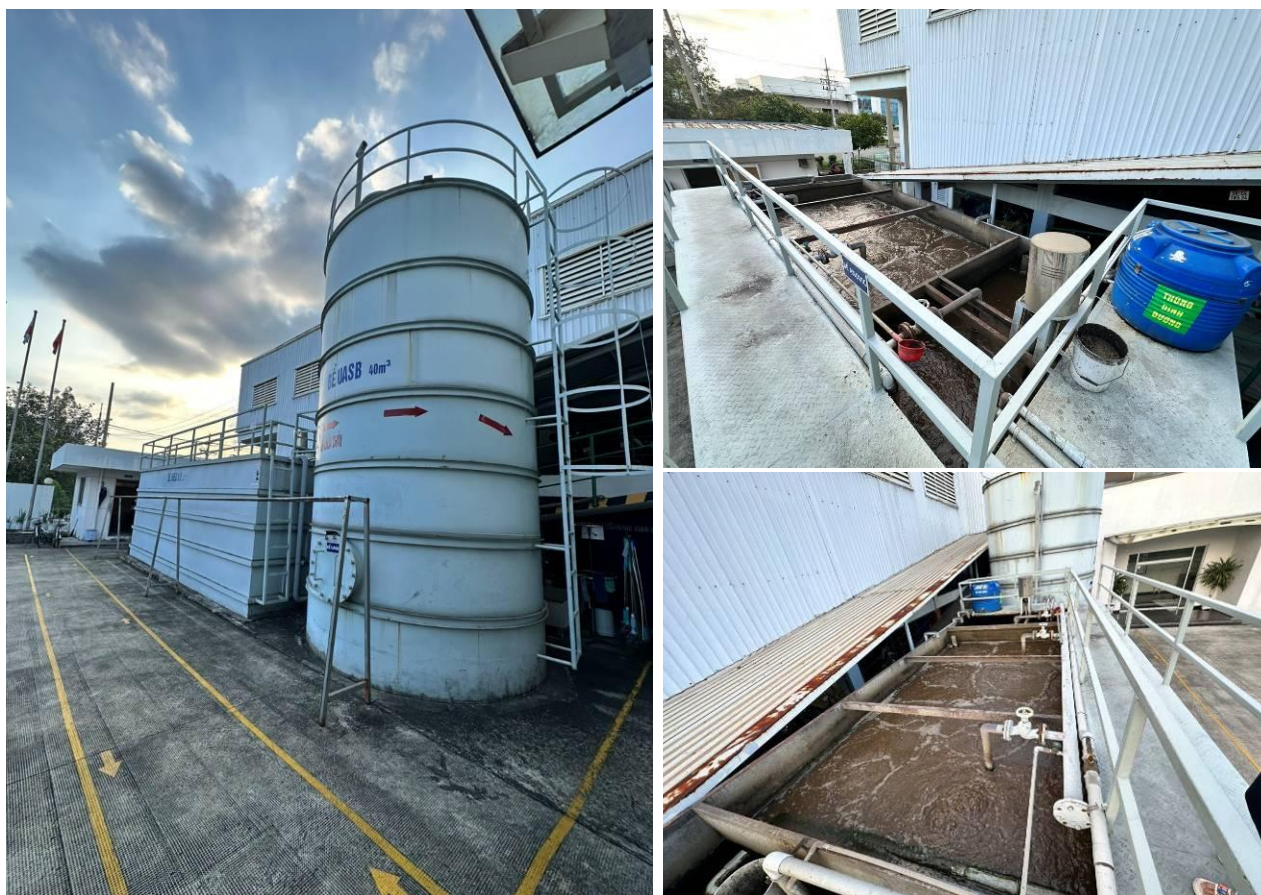
Hình 3.9. Hình ảnh thể hiện cụm bể xử lý sinh học tại nhà máy 2.
