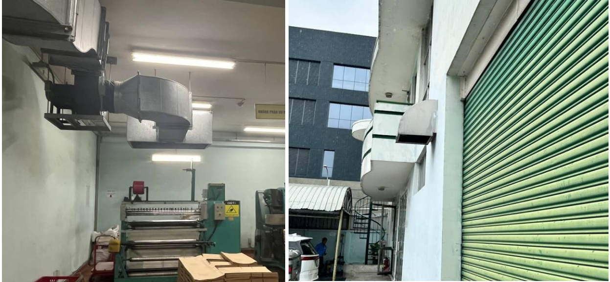
Hình 3.11. Hệ thống hút bụi tại khu vực máy cắt chia cuộn của nhà máy 1.
