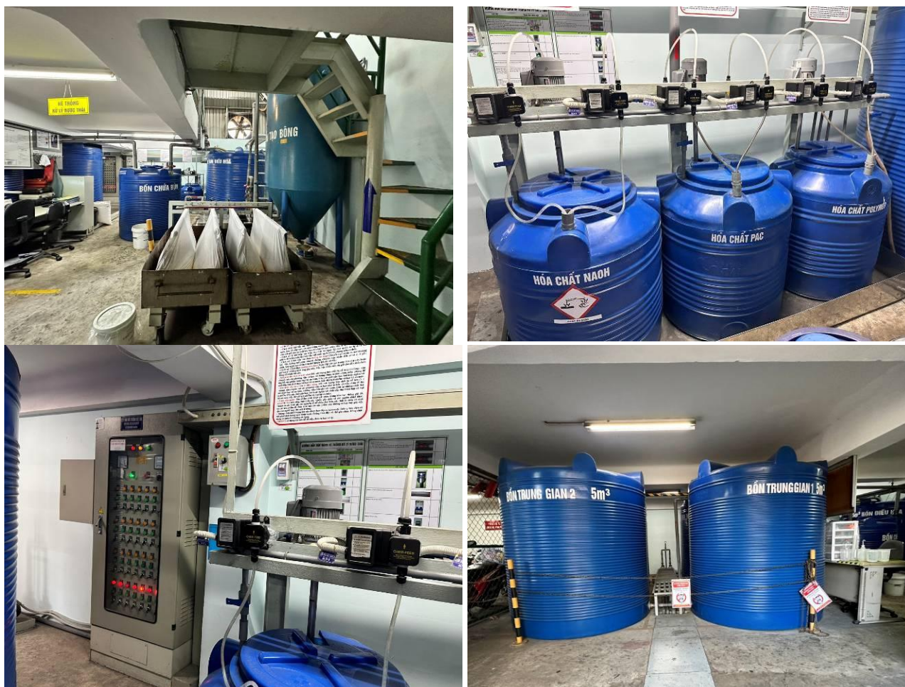
Hình 3.8. Hình ảnh thể hiện cụm bể xử lý hóa lý tại nhà máy 2.
